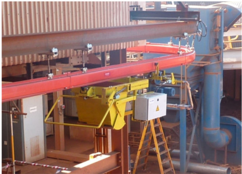
Fig. 2: Vue du système de transport d'échantillons à Port Hedland
