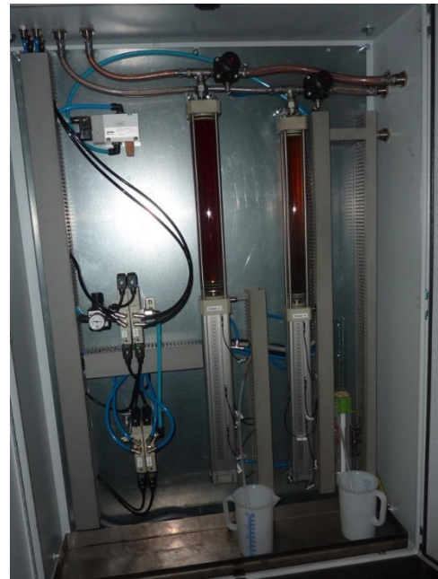
Fig. 2 : Armoire de dosage de liant avec deux pompes doseuses
